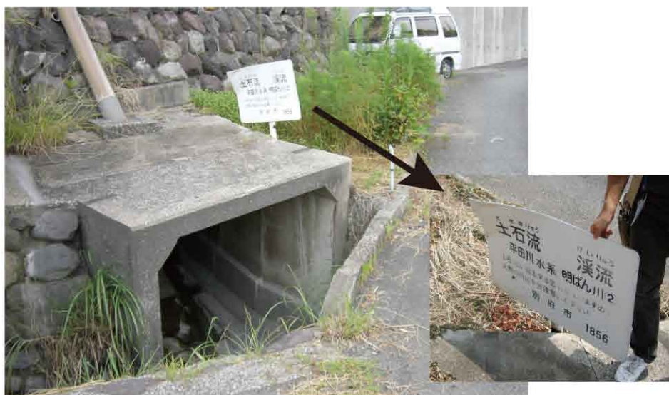
土石流危険地帯と地すべり
