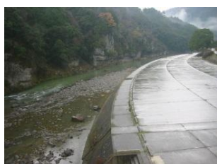
頼山陽も嘆く現代版の嗚呼造物 奇怪コンクリートの景
